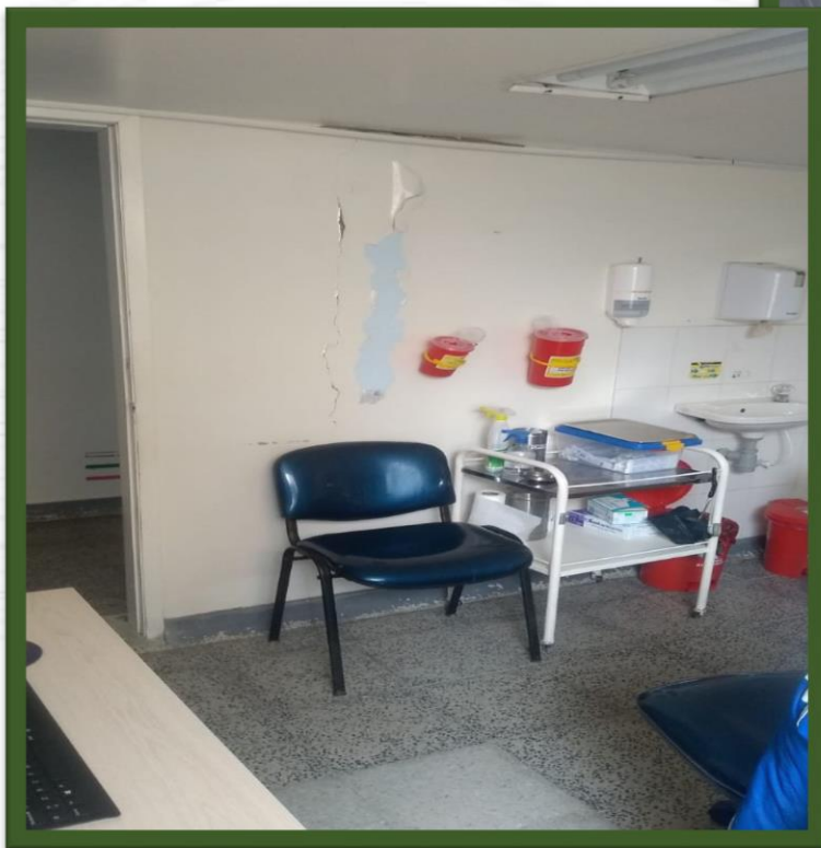
Grietas - Consultorio de Vacunación
