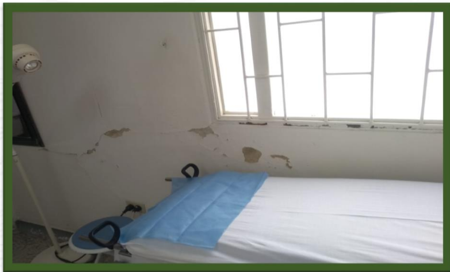
Grietas – Consultorio de Enfermería
