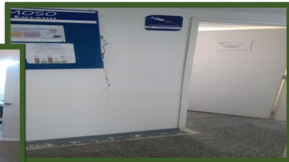
Grietas - Salas de Espera
